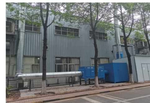
轨道交通事业部空簧车间硫化废气无组织废气治理
