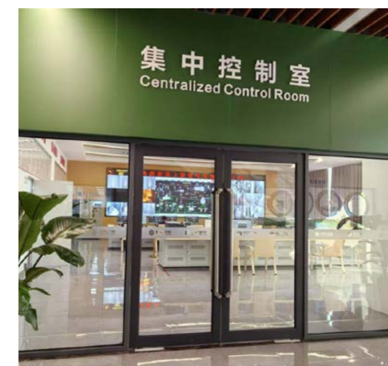
怀化生活垃圾焚烧发电项目控制室
