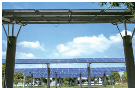
新增光伏車棚
