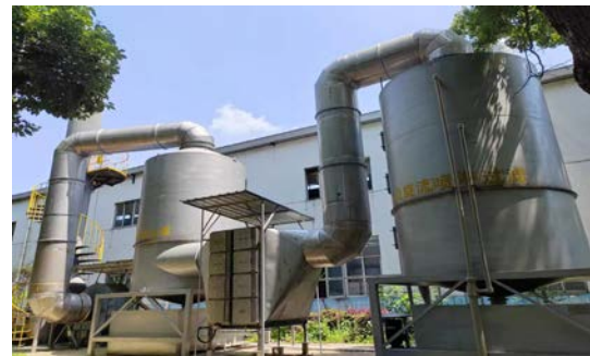
烟气净化处理设施
