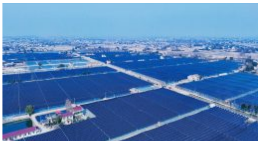
兰溪渔光互补光伏项目现场图
